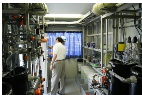
屋内ろ過装置
